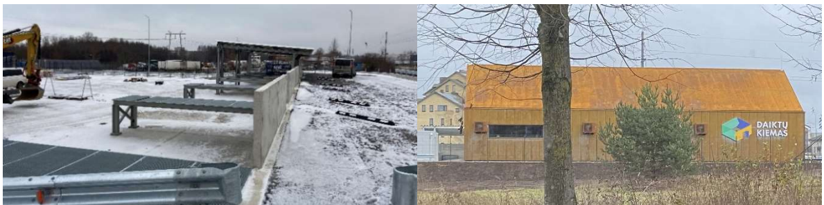
Pav. 10 Šiaulių m. didelių gabaritų atliekų surinkimo aikštelė, kurioje įrengta atliekų (daiktų) paruošimo naudoti pakartotinai infrastruktūra
